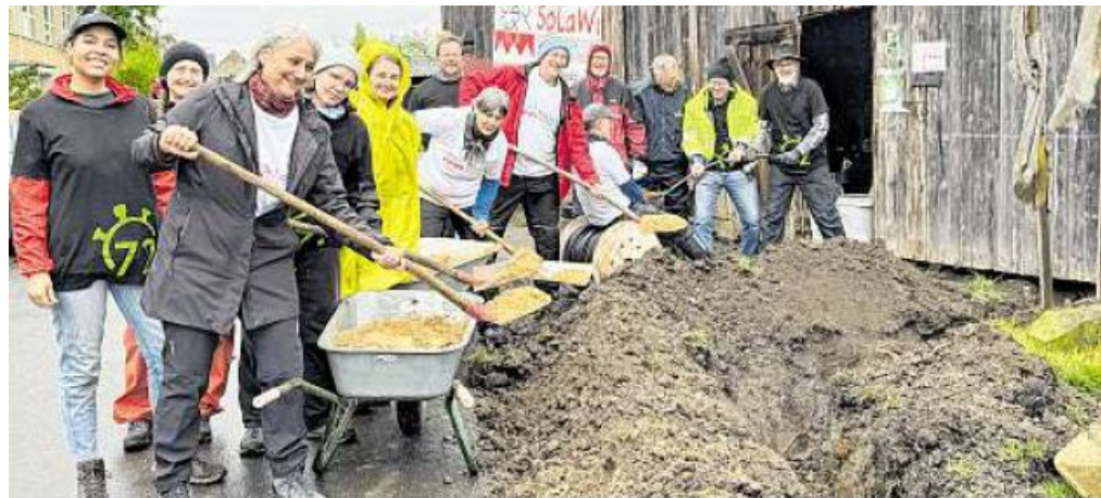
Gemeinsam für den guten Zweck: Bei der SoLaWi in Bergheimfeld packen alle für den Bau einer Pergola an; hier bei der Verlegung des 100 Meter langen Erdkabels.
