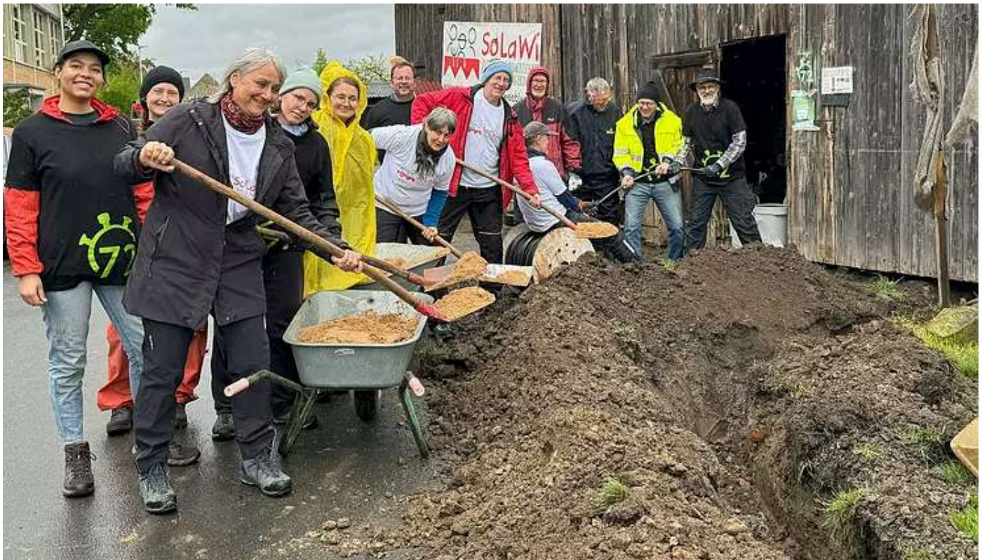
Foto: Daniela Schneider | Gemeinsam für den guten Zweck: Bei der SoLaWi in Bergheinfeld packen alle für den Bau einer Pergola an; hier bei der Verlegung des 100 Meter langen Erdkabels.
